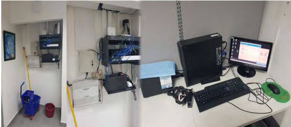
Figura 1 Imágenes de las instalaciones tecnológicas ante de la intervención.
