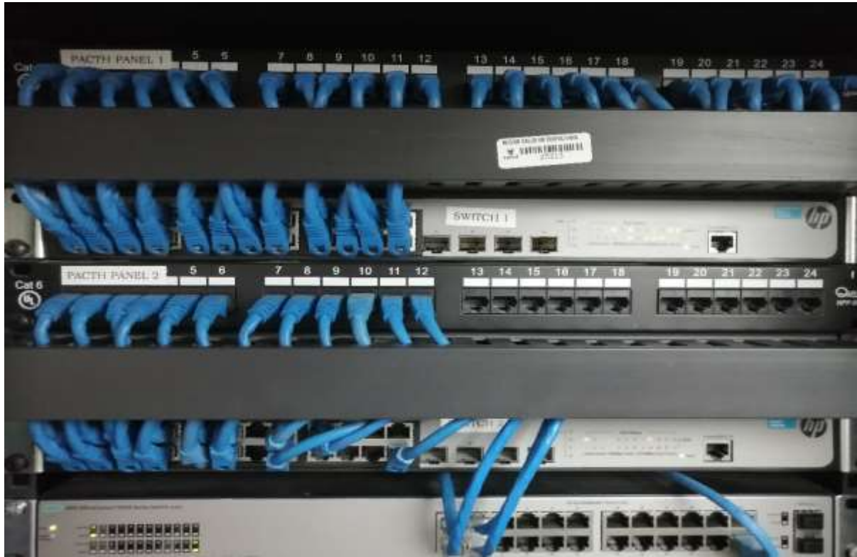
FIGURA-7-EQUIPOS DE COMUNICACIÓN
