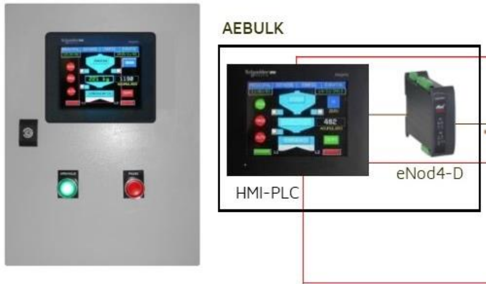
Anexo 5: Panel de control automatizado de pesaje
