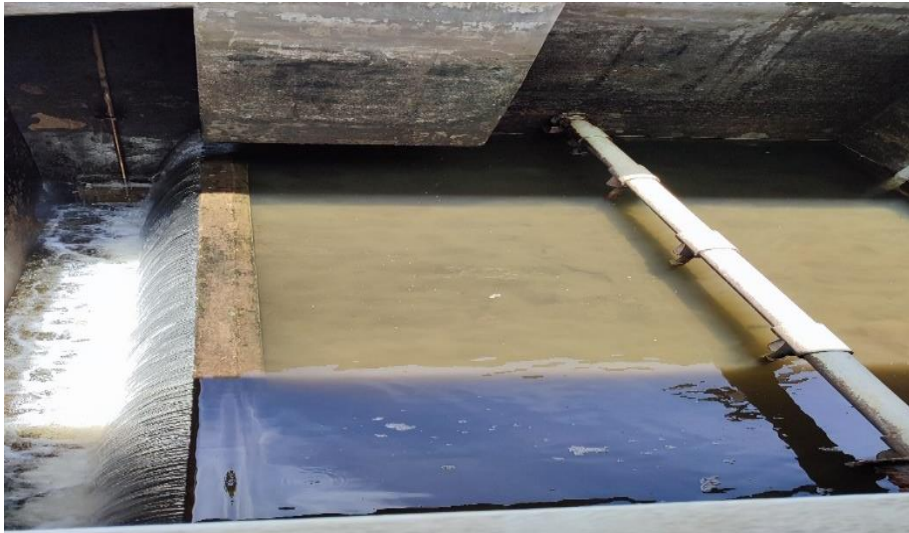
Figura No. 9: Lavado Filtros, proceso de retro lavado
