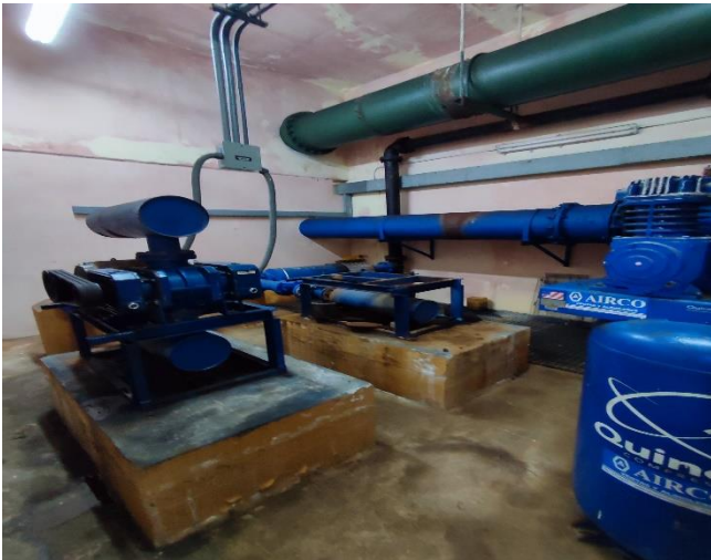
Compresor de aires para sopladores
