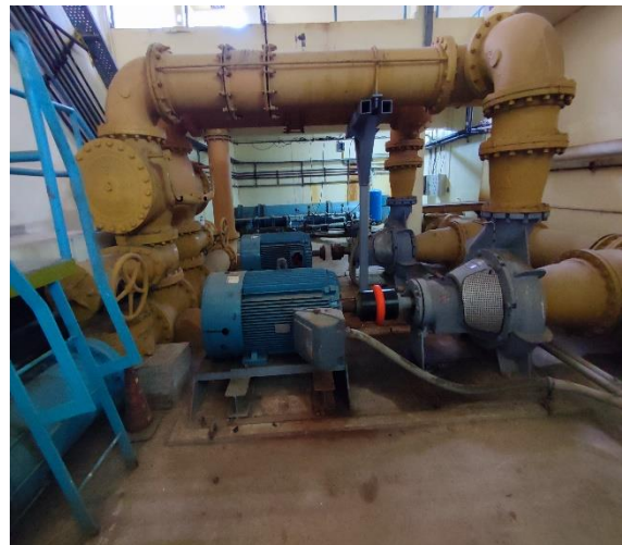
Bomba de agua de lavado de filtros
