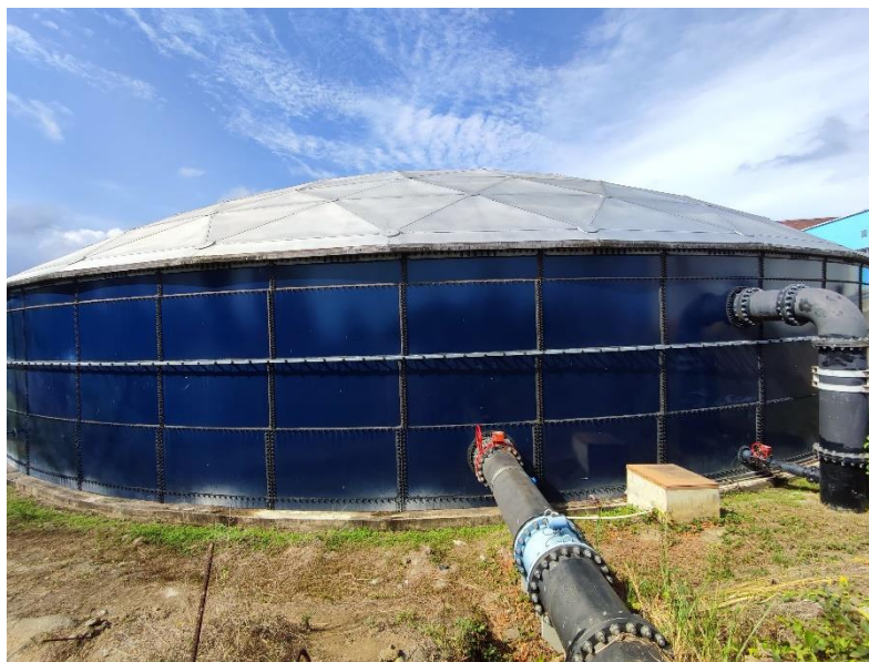
Figura No. 10: Tanque de almacenamiento de agua potable
