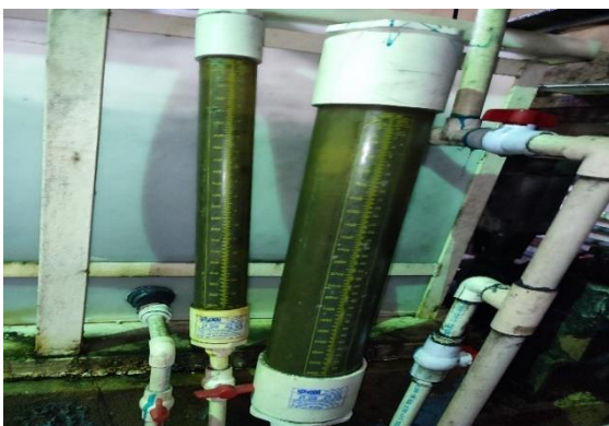
Figura No. 5: Cilindros de medición del bombeo de solución de alumbre
