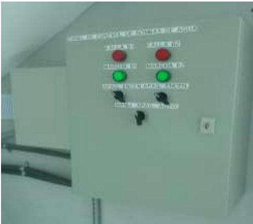
Figura 35 Panel de control de bomba de agua.
