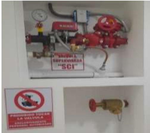
Figura 37 Válvula SCI de alivio de presión.
