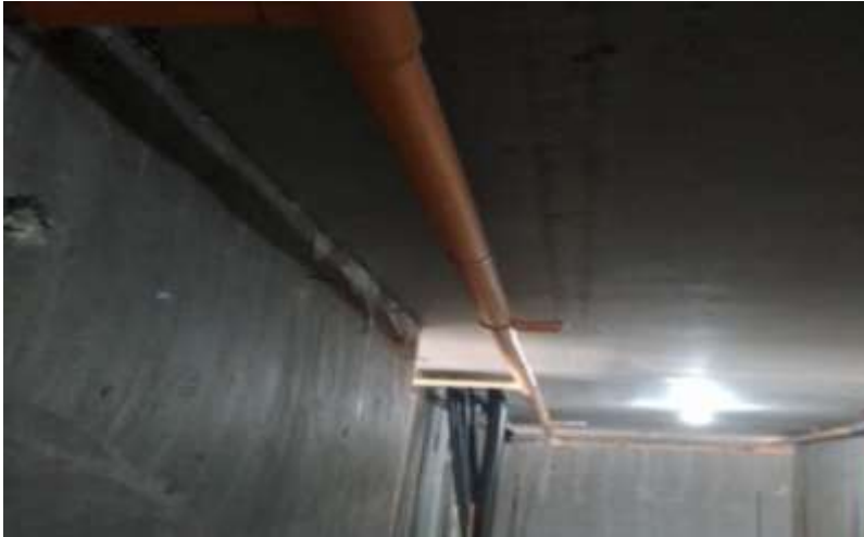
Figura 42 Sistemas contra incendios, norma (NFPA 13).
