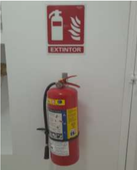
Figura 39 Extintor contra incendios, norma (NFPA-10).
