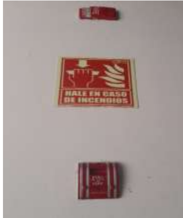
Figura 44 Alarma contra incendios, norma NFPA 72 / NFPA 101.
