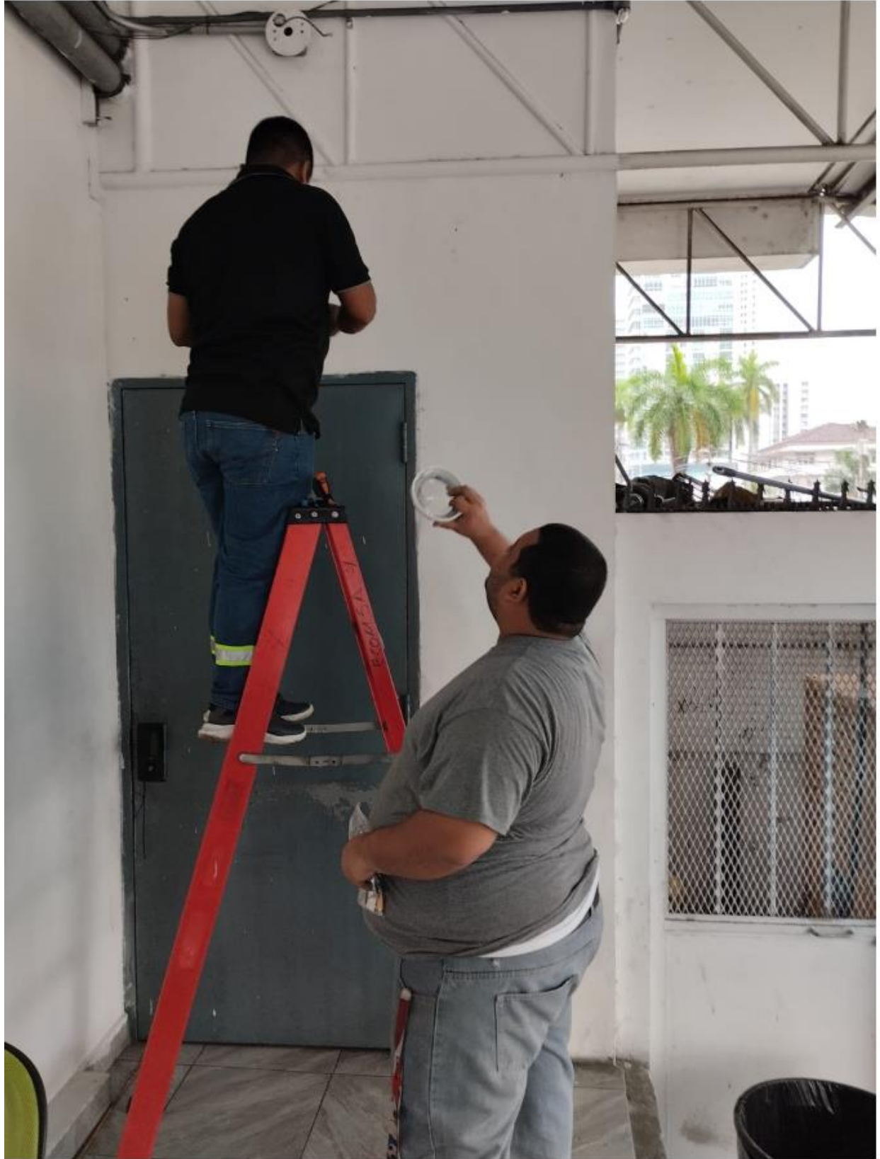
Ilustración 22: Reemplazo de cámara en el exterior del Sitio alterno
