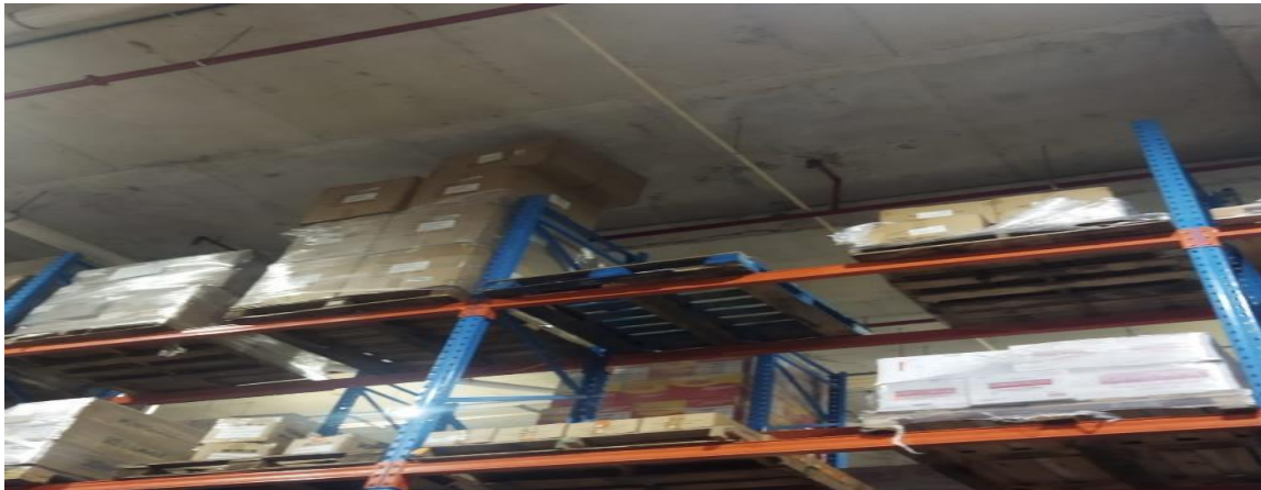
Figura 26 Almacenamiento inadecuado por estibas altas.
