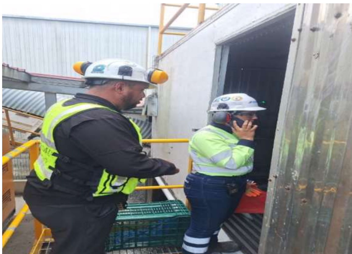
Figura 55. Se mantiene inspección de las distintas partes de la obra en la misma se encontraron algunas falencias que se corrigieron inmediatamente. (Autoría propia)
