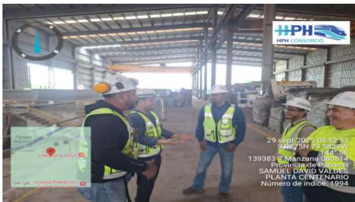
Figura 86. Se realizo recorrido de cierre en la nueva planta de Invert box. (Autoría propia)
