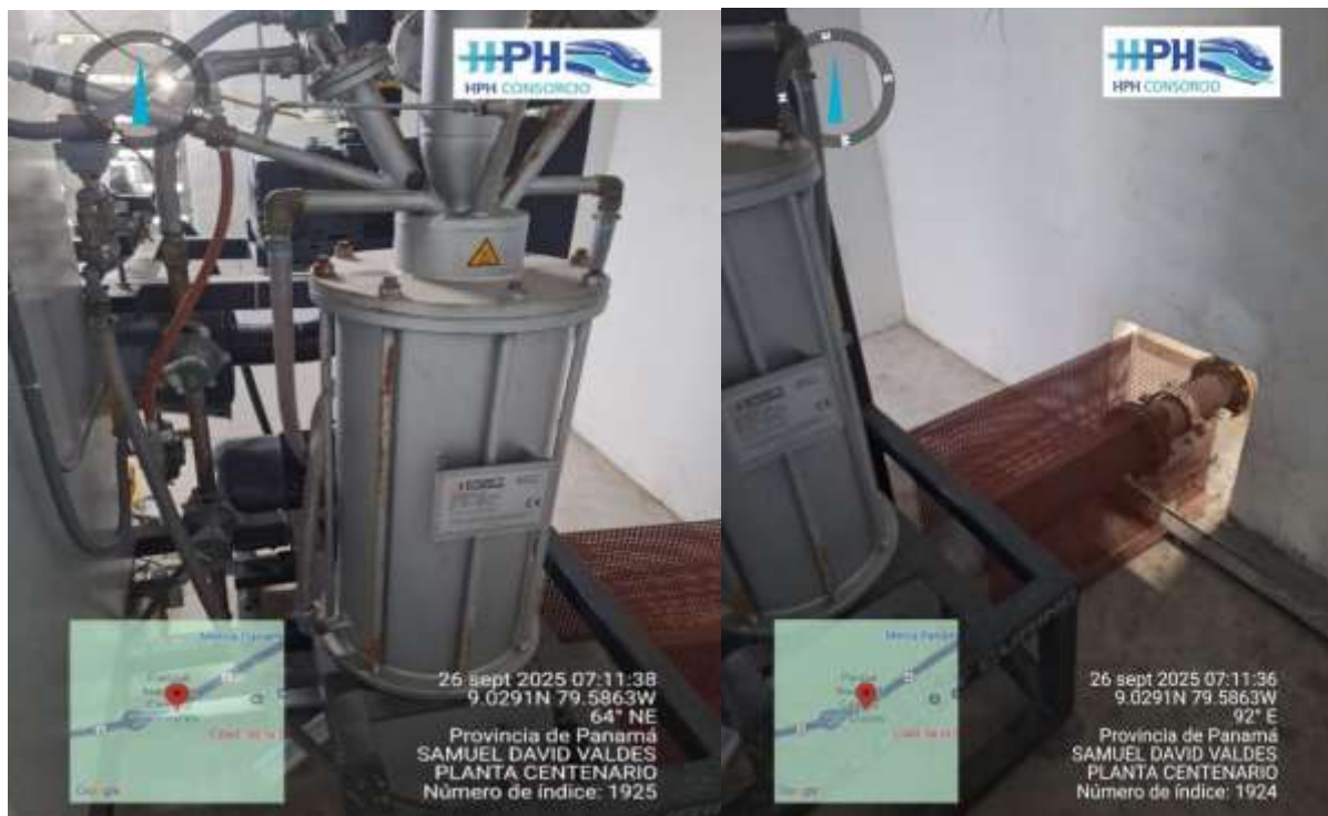
Figura 72. Se realizo inspección de tubería de gas presurizada para el horno debido a fallo reportado en la misma. (Autoría propia)
