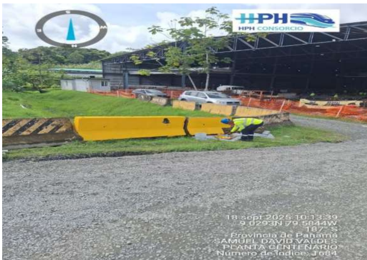
Figura 65. En recorrido se levantó una notificación subcontratista sobre la falta de mantenimiento de barreras rígidas las mismas fueron corregidas inmediatamente. (Autoría propia)
