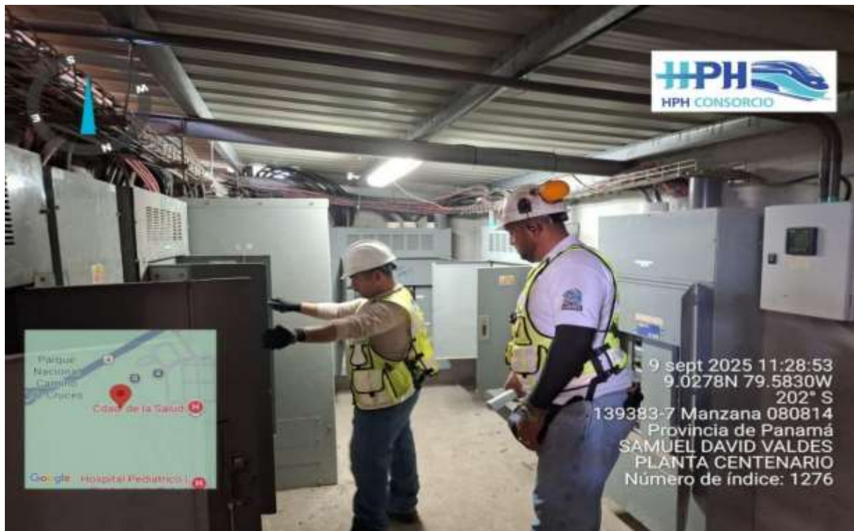
Figura 52. Dentro de la semana de inspección eléctrica también pudimos conocer más del funcionamiento eléctrico de la planta así como los distintos voltajes a utilizar en dicha planta. (Autoría propia)
